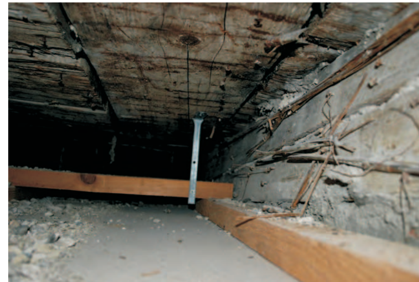
T 500 - Bereich Decke über Flur B 3.02 Deckenuntersicht über abgehängter Decke aus GK-Platten, Blick in Richtung Norden
